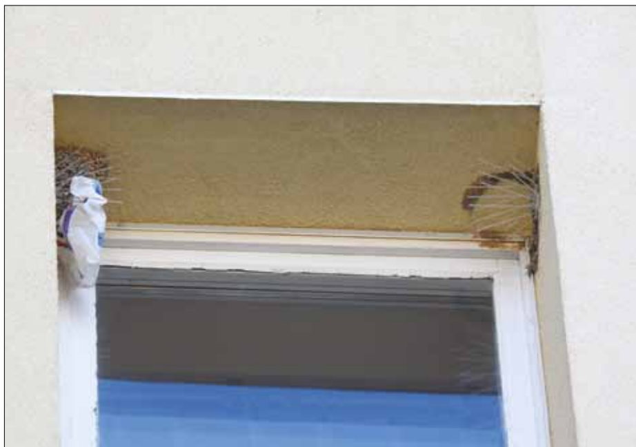
Fot. 109. Nawet jeśli architektura sprzyja ptakom, to ptasie towarzystwo nie zawsze podoba się ludziom. Reklamówki i kolce na ptaki zamontowano tu do zniechęcenia oknówek przed budową gniazd we wnękach okiennych. Fot. P. Mirski
