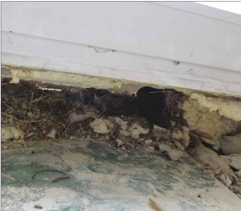
Fot. 39. Gniazdo jerzyka w remontowanym budynku. Fot. P. Mirski
