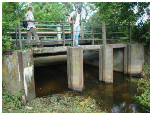
Fot.8.2. Po prawej: jaz piętrzący dawniej wodę w zbiorniku przepływowym powyżej ulicy Dojlidy Fabryczne – obecnie nieczynny z powodu braku elementów piętrzących.
