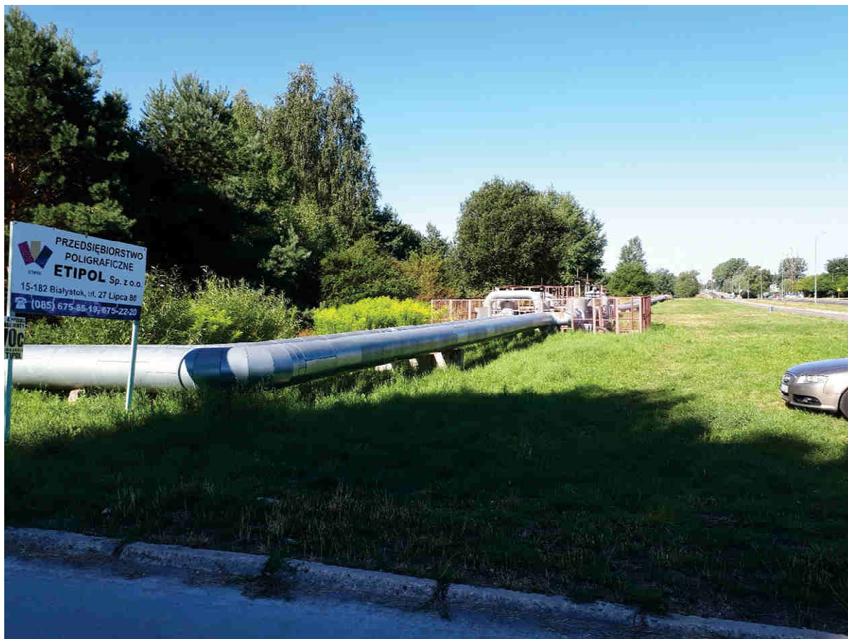
Fot. 52 Kolektor ciepłowniczy przy ul 42. Pułku Piechoty w sąsiedztwie os. Wygoda
