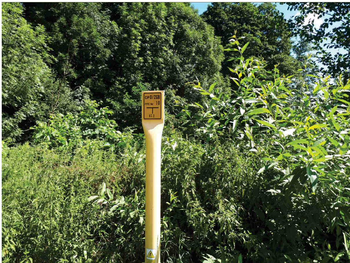
Fot. 53 Oznaczenie przebiegu kolektora gazu wysokiego ciśnienia
