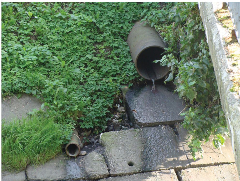
Fot. 6.1 Wyloty kolektorów
